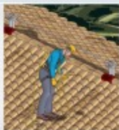
Colonnina verticale + cavo
